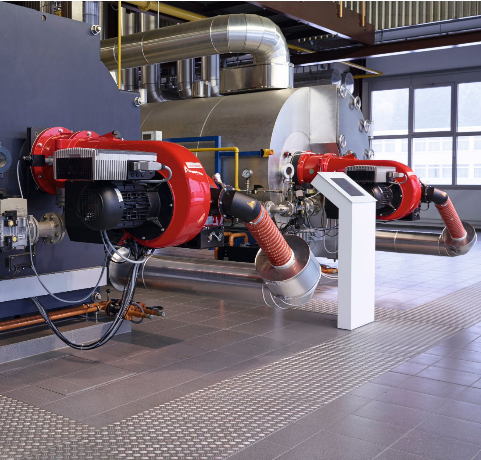
Langtidstest med røggastilbageføring i varmecentralen på Weishaupts egen fabrik
