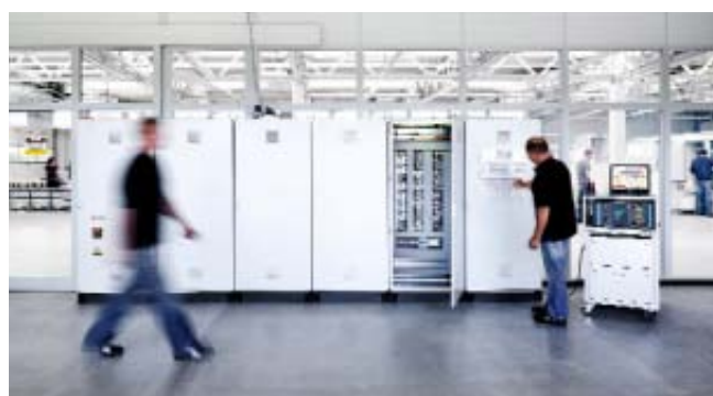
La fabrication des armoires de commandes électriques relève des compétences de la filiale Neuberger.
