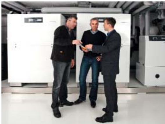
A Warnemünde, trois pompes à chaleur produisent de la chaleur à partir de l'eau de la Mer Baltique.
