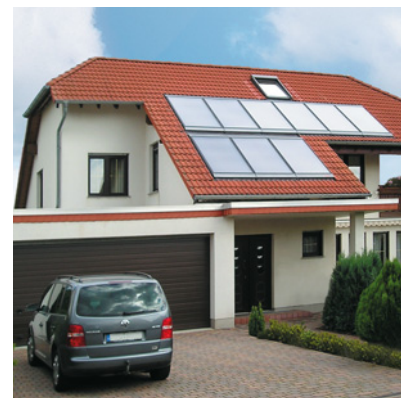
Systèmes solaires WTS-F1 en intégration de toiture
